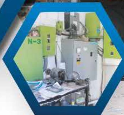
CAPACITORES Y EQUIPO
